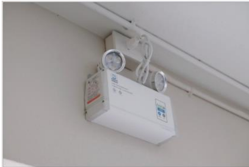
เครื่องกำหนดไฟฟ้า (กรณีไฟฟ้าดับ)
